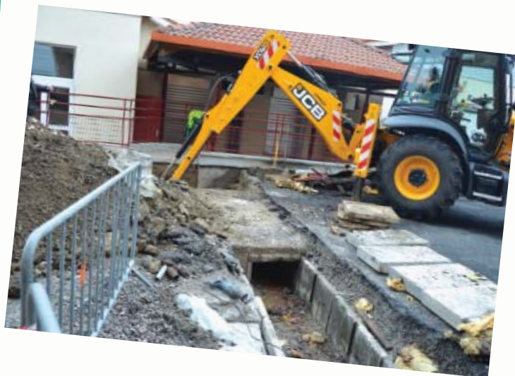
Les bâtiments communaux du centre-bourg sont alimentés en chauffage par un réseau de chaleur partant de la mairie. Ce réseau, datant de 1982, a subi les désagréments du temps, il a dû être remplacé en urgence pendant les fêtes de fin d'année. En effet, les tuyaux situés sous la chaussée étaient percés au niveau de la salle polyvalente et au niveau du restaurant scolaire.
