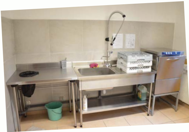
La cuisine de la salle polyvalente a fait peau neuve. Cet équipement très utilisé par les associations et pour les manifestations municipales s'est enrichi d'un lave-vaisselle et d'une "plonge" de type professionnel. Nul doute que cette modernisation fera l'unanimité auprès des bénévoles.
